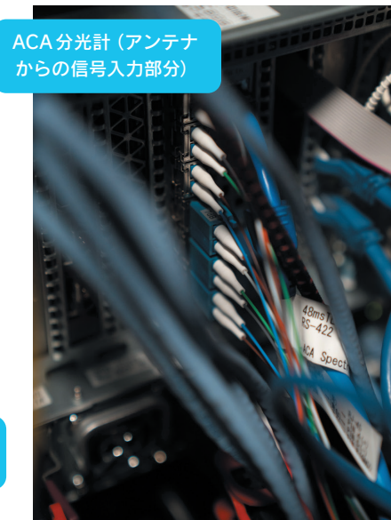
ACA 分光計が設置され ている現地の相関器室
