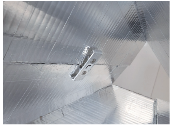
図3-09 ホーン本体部とホーン喉元部を固定する金具。
