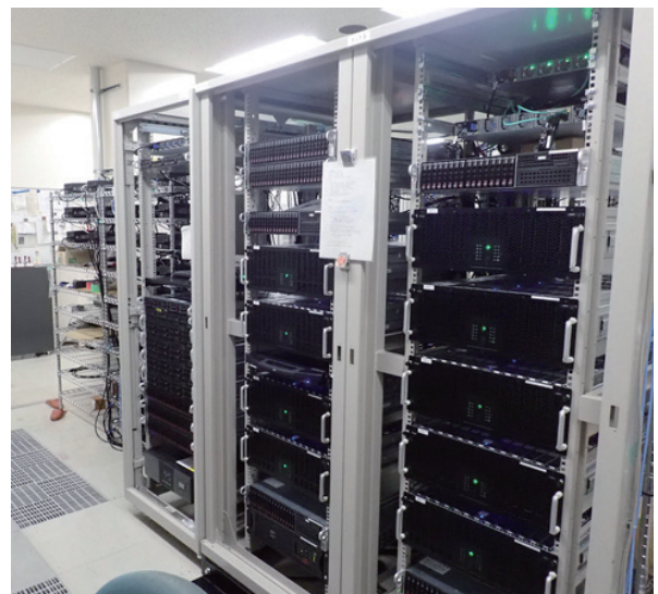
図1：システム全景.
