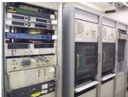
図01 NTPサーバー及び時計監視装置。
