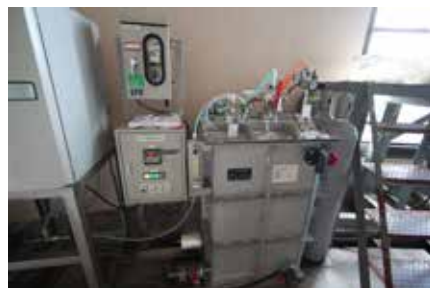
▲純水製造装置
